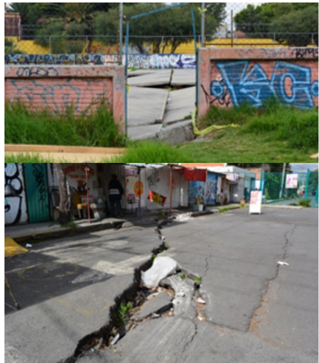
Imagen 71 y 72. Daños en la Villa Centroamericana tras el sismo de 2017. Fuente: https://www.unotv.com/noticias/porta/investigaciones-especiales/detalle/la-villa-centroamericana-a-punto-del-colapso
